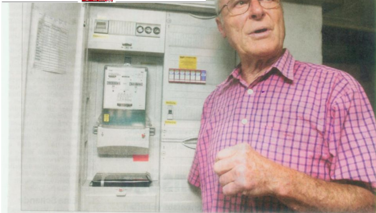
Am „Einspeiseschrank“ der Photovoltaikanlage in der Burkhardstraße 13 bis 17 in Triptis erläutert Hans-Peter Käppel, dass die Jahresstromproduktion für die Versorgung des halben Blocks reichen würde. (Fotos [2]: OTZ/Marius Koity)
